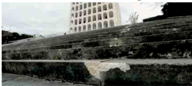
La scalinata danneggiata del Palazzo della civiltà del lavoro, il colosso quadrato (Foto TOATI)
